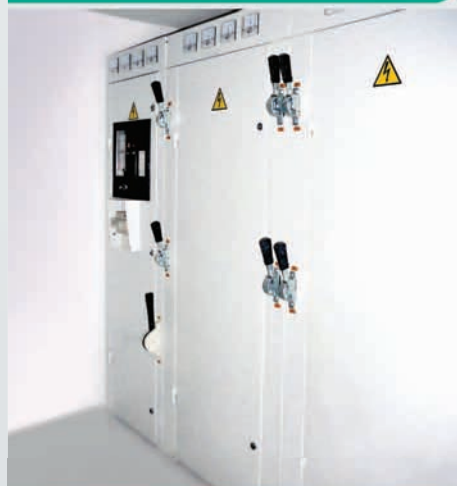
Распределительное устройство 0,4 кВ
